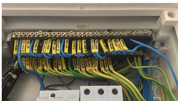
(a) Hlavní svorkovnice vodičů N a PE v rozvaděči
