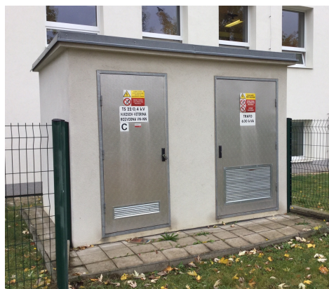
(a) Distribuční transformátor
