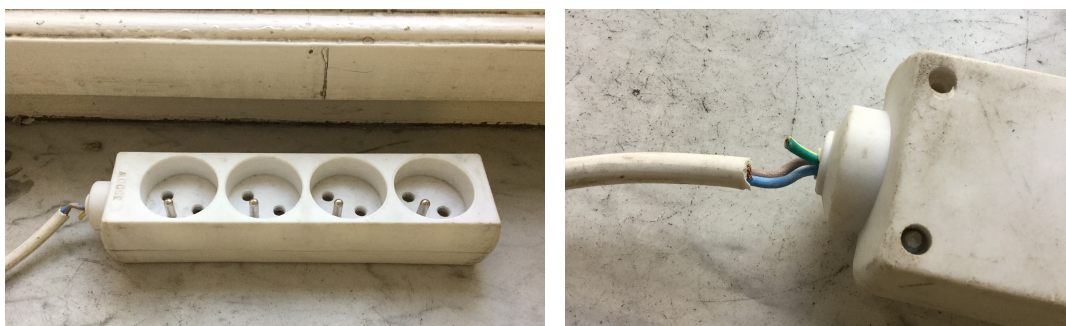
(a) Vzezření běžné postarší prodlužovací šňůry (b) Přerušený ochranný vodič v přívodu
