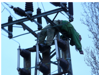
(a) Konečná (trafo)stanice
