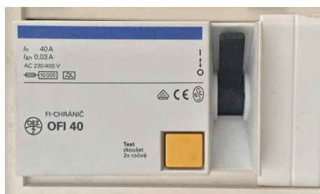
Obrázek 4.46: Proudový chránič instalovaný v hlavním rozvaděči
