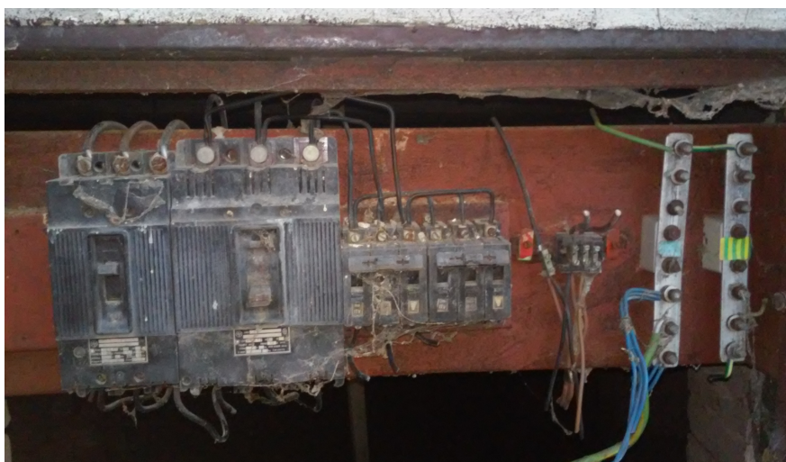
Obrázek 4.54: Rozvod starého mlýna zoufale vyhlížející rekonstrukci
