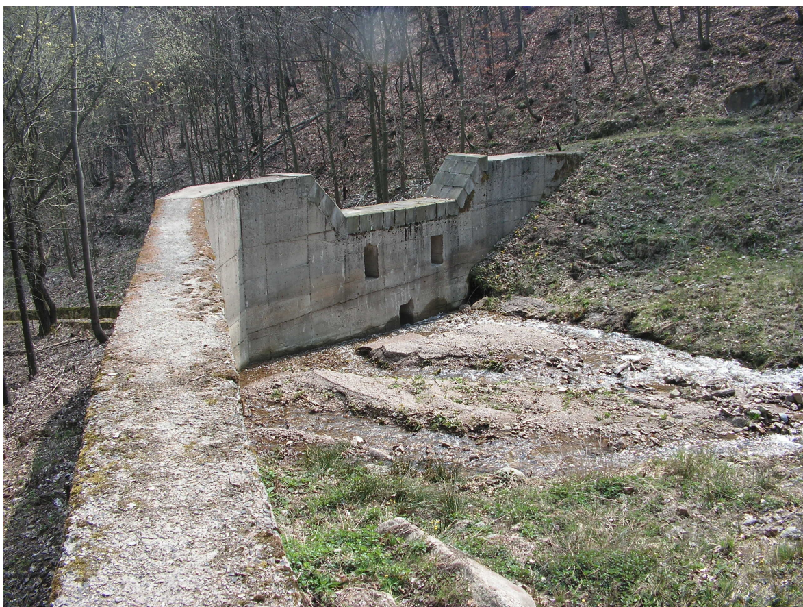
Příloha 53: Stěna zabaňující průniku podzemní vody z povodí Sramnického potoka do kvartérních sedimentů (foto: autor).
