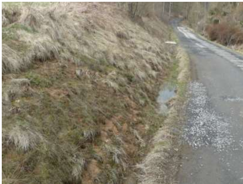
DB33a – Břeh nad silnicí Cihlářská, zvodnělá spodní část svahu
