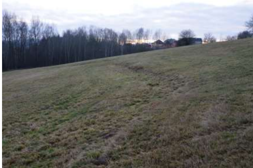
DB26a – Trhlina ve svahu
