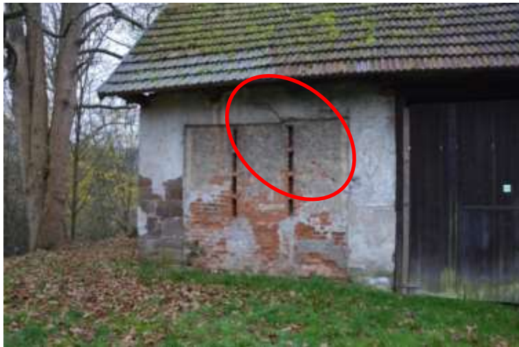
DB02 – Trhlina ve stěně budovy
