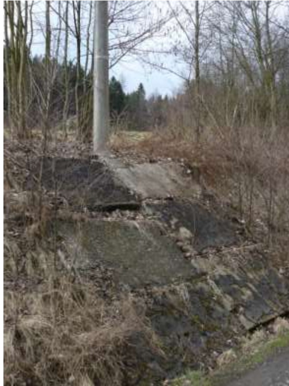
DB34 – Betonové zatěžovací desky v okolí sloupů
