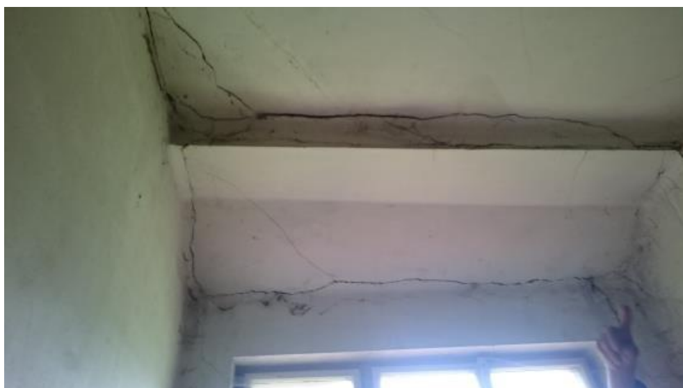
Obr. 24: Praskliny ve zdech domu v ulici Chochołka 401 (vlastní dokumentace)
