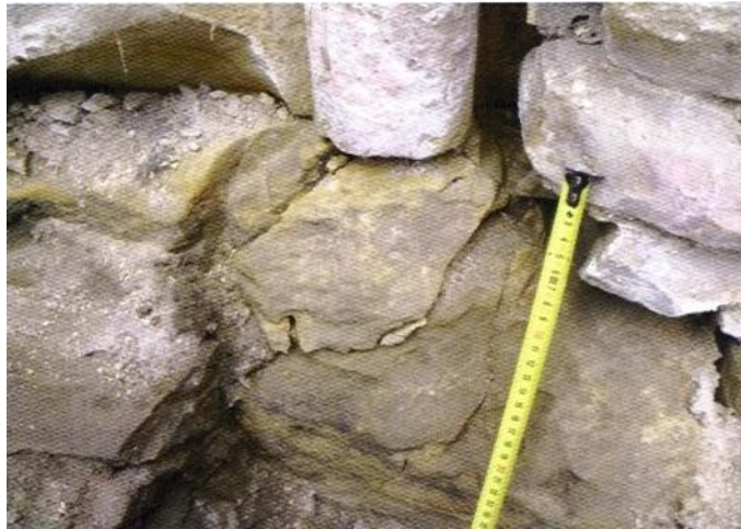
41. Praha , kostel Panny Marie pod řetězem, pohled na patku prutu okenního ostění
