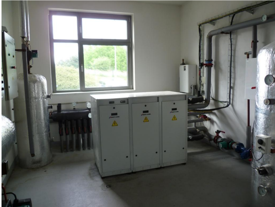
Obrázek 3.3: Strojovna s tepelným čerpadlem Plzeň – Mikulka
