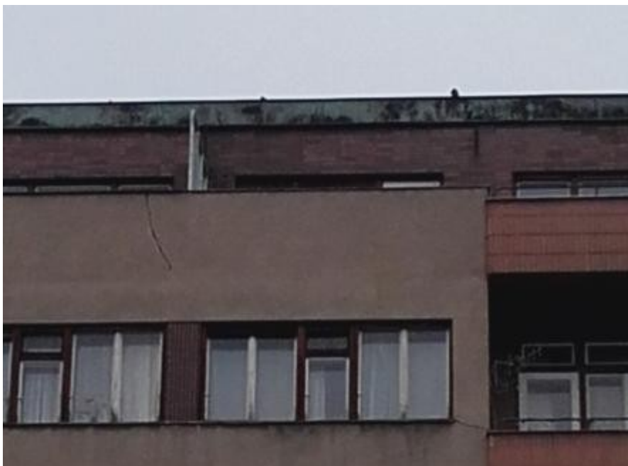
Obr 24: Detail trhliny na objektu Milady Horákové 849/88. Trhlina je dlouhá přes 1 metr a široká 1 cm.
