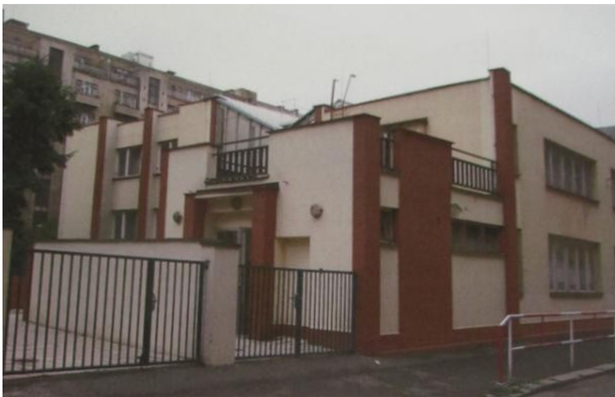
Obr 6 : Pohled na objekt Na Výšinách 3/1075 na východní část budovy B1 vlevo a B2 vpravo. Opadnutí omítky na budově B2 nesouvisí s ražbou tunelů. (stav léto 2008, archiv MŠ Na Výšinách)
