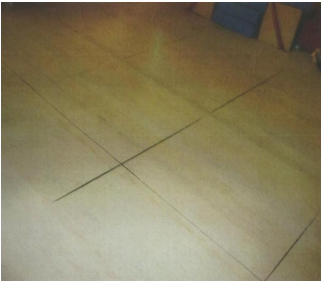
Obr 8 : Archivní snímek poškozené podlahy v místnosti lehárny/herny v JV rohu budovy B1 v důsledku nerovnoměrného sedání objektu (archiv MŠ Na Výšinách).
