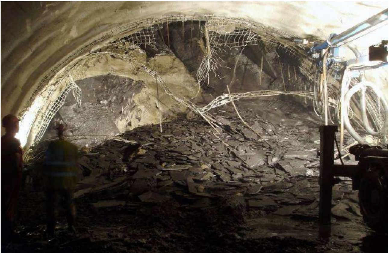
Obr 13: Pohled na zavalenou čelbu krátce po vzniku havárie dne 20.5.2008 (Satra spol s r. o.)
