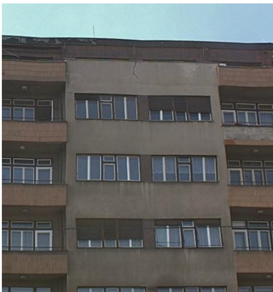
Obr 25: Podobná trhlina na východní části sousedního objektu Milady Horákové 848/90. Archivní snímek z jara 2014 (Google)
