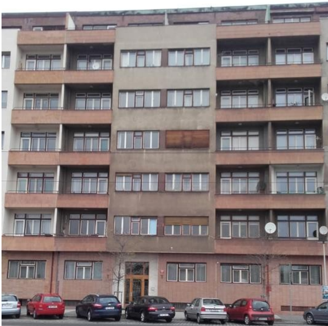
Obr 23: Objekt Milady Horákové č. p. 849/88 při pohledu od Letenské pláně. Ostatní domy bloku „Molochova“ mají od jihu identický vzhled. V posledním patře nad vchodem je patrná vertikálně orientovaná trhлина vzniklá pravděpodobně teplotní roztažností objektu a nikoliv vlivem ražby . Dle sdělení místních obyvatel je trhлина staršího data než tunel.
