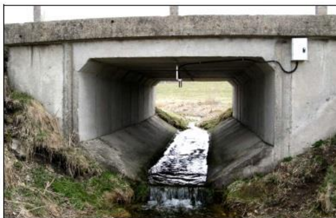
Obr. 33 Hladinoměr se záznamovou jednotkou M4016. Zdroj: Hujšlová, 2010
