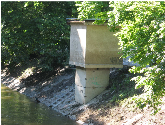
Obr. 37 Vodoměrná stanice v Libni
