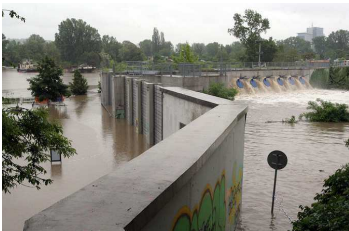
Obr. 85 Zavřená protipovodňová vrata, Rokytka vlevo
