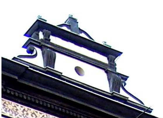
80) Štít na domě na rohu ulic Na Poříčí a Havlíčkova, Praha 81) Štíty na plzeňské radnici
