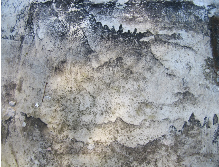
Obr. 78: Fotografie: detail skvrn na betonu
