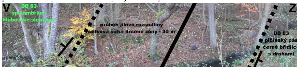
Obr. 7.6. Profil jílovou rozsedlinou na březích Trnovského potoka.
