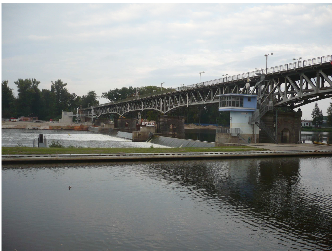
Obr. 16: Most se zrekonstruovaným jezem roudnického zdymadla v roce 2013 Fotoarchiv autora (foto z 8. 9. 2013).
