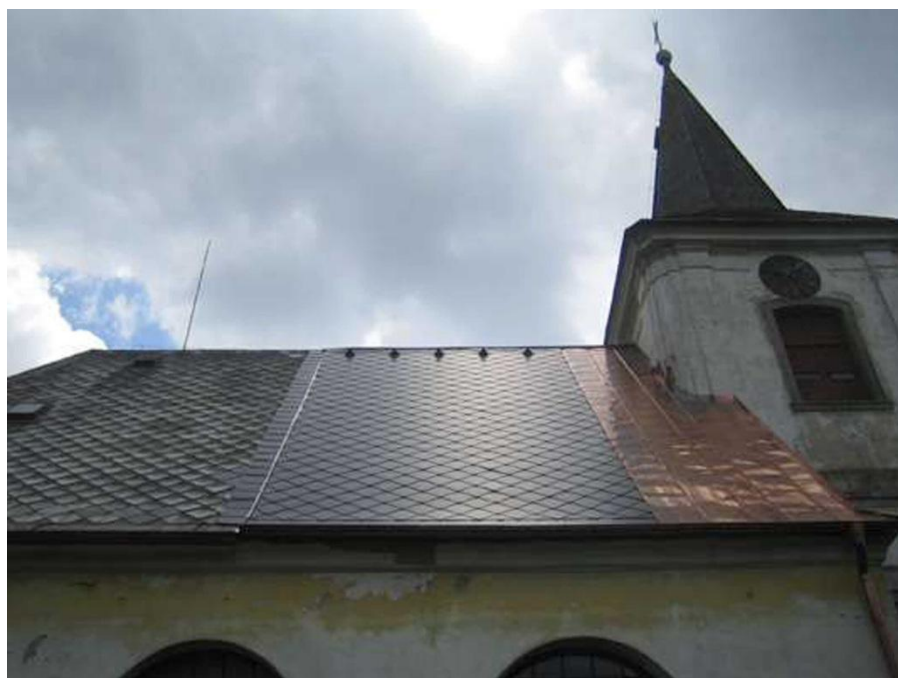
26. Bartošovice v Orlických horách , kostel sv. Máří Magdalény, 1673, přestavba 1731–1746, stav v roce 2006, pohled od severu
