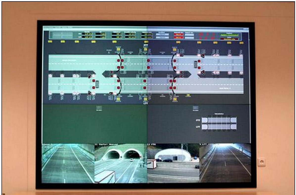
Obr. 18: Řídicí software tunelu Valík
