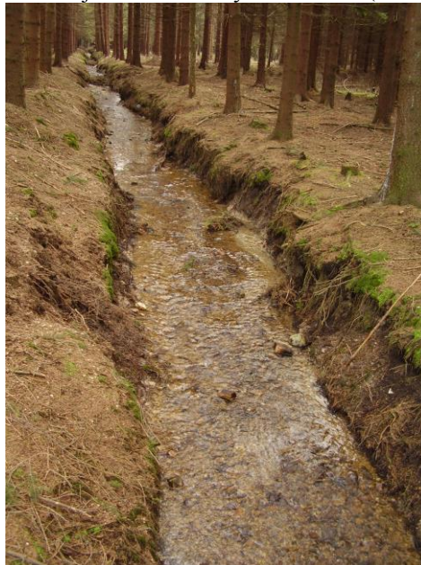
Foto 29: Napřímené koryto téhož toku s břehy sesouvajícími se do koryta - P05004 (III. ES)
