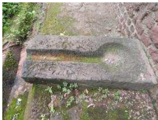
Obrázek 30: Wittlich, odvodňovací kanál
