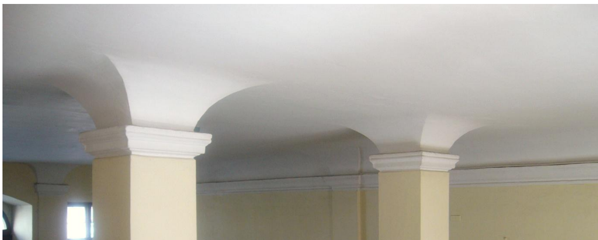
Obr. 65 Fabion stropu vstupního sálu.
