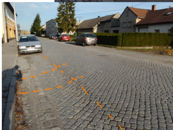
OBRÁZEK 86: POHLED NA POSTIŽENÉ ÚSEKY ZE ZVÝRAZNĚNÍM PRŮBĚHŮ DEFORMACÍ.
