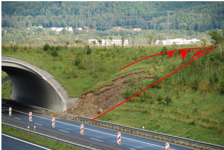
OBRÁZEK 63: POHLED NA SESUV, VZNIKLÝ 26.-27.8.2010. FOTO Z 30.8.2010, Z ARCHIVU AUTORA
