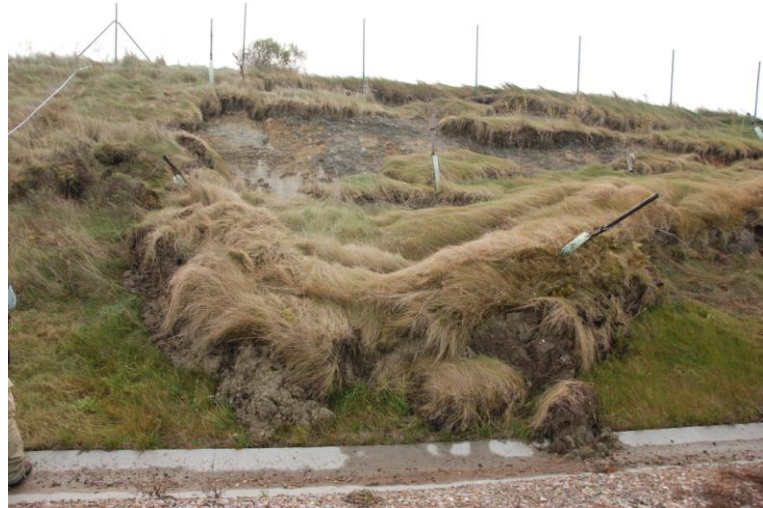
OBRÁZEK 84: POHLED NA JEDNO Z MÍST POSTIŽENÝCH SJÍŽDĚNÍM HUMÓZNÍHO POKRYVVU, 16.10.2010.
