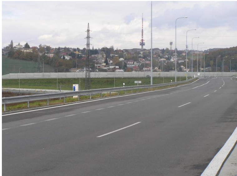
OBRÁZEK 29: POHLED NA ÚSEK PORUŠENÝ VERTIKÁLNÍMI DEFORMACEMI. KRESTA, 2011
