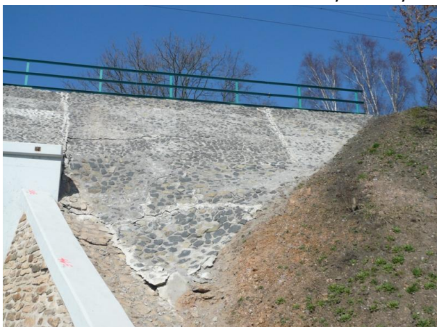
OBRÁZEK 39: POHLED NA TRHLINY, VZNIKLÉ V POVRCHU ZÁDLAŽBY. Z ARCHIVU FIRMY 4G CONSITE
