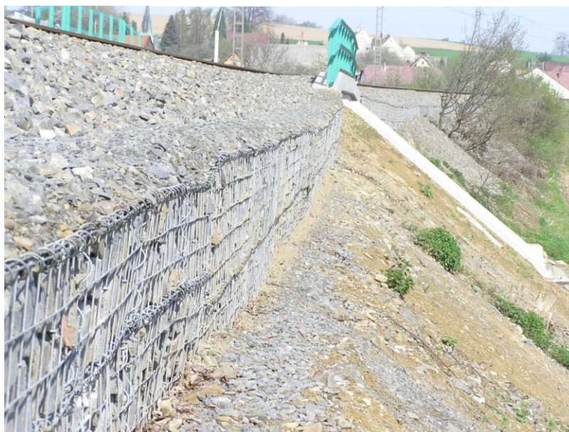
OBRÁZEK 47: POHLED NA DEFORMOVANOU GABIONOVOU ZÍDKU Z 15.5.2006. KRESTA, 2007
