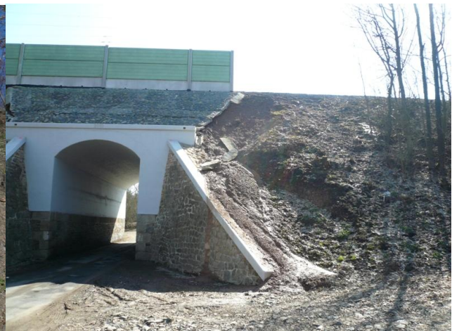
OBRÁZEK 38: SESUV VZNIKLÝ PODÉL OKRAJŮ MOSTNÍCH KŘÍDEL. Z ARCHIVU FIRMY 4G CONSITE
