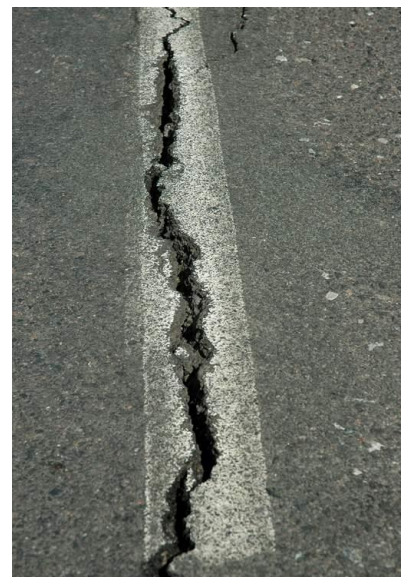
OBRÁZEK 67: UKÁZKA TRHLIN V ULICI VÝŠINKA. OBECNÍ STRÁNKY MĚSTA TURNOV
