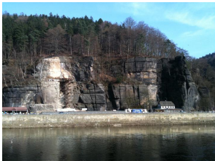
OBRÁZEK 43: CELKOVÝ POHLED NA POSTIŽENOU SKALNÍ STĚNU
