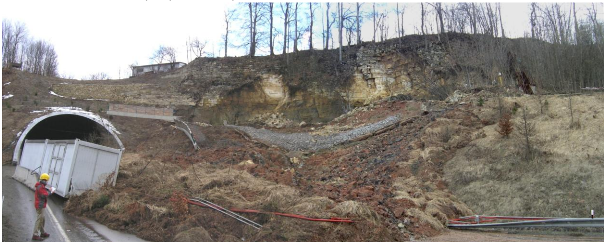
OBRÁZEK 41: POHLED NA SESUV U PORTÁLU HŘEBEČ. Z ARCHIVU MGR. BOHÁTKOVÉ
