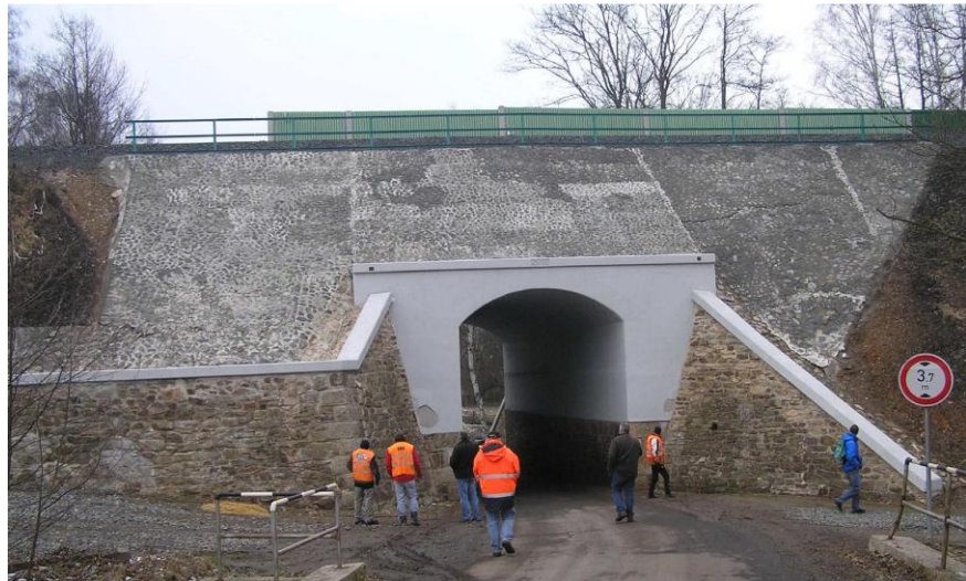
OBRÁZEK 37: CELKOVÁ SITUACE POSTIŽENÉHO ÚSEKU NÁSYPU. BOUŠKA, 2011.
