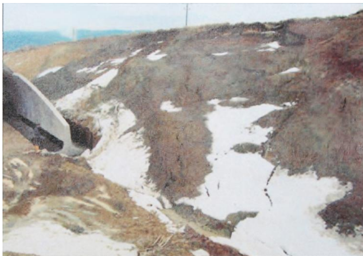
OBRÁZEK 62: POHLED NA VZNIKLÝ SESUV ZA KONSTRUKCÍ BIKORIDORU.
