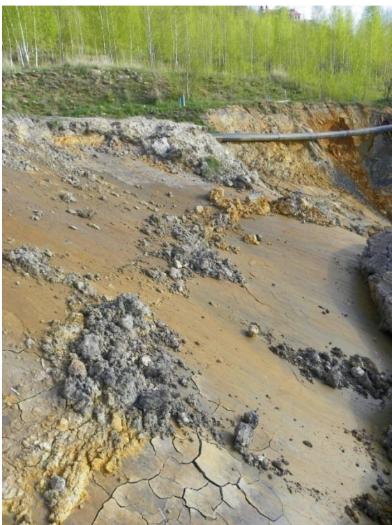
Obr. A2.23 Příklad dokonale vyhlazené smykové plochy v odlučné oblasti sesuvu (foto: J. Burda, 21. 4. 2010).
