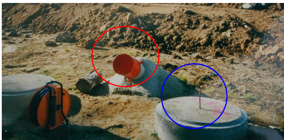
(obr.3 – fotografie ústí měřicí trubky spolu s referenčním bodem, dle Instruktažní příručka SG – Geotechnika a.s.)
