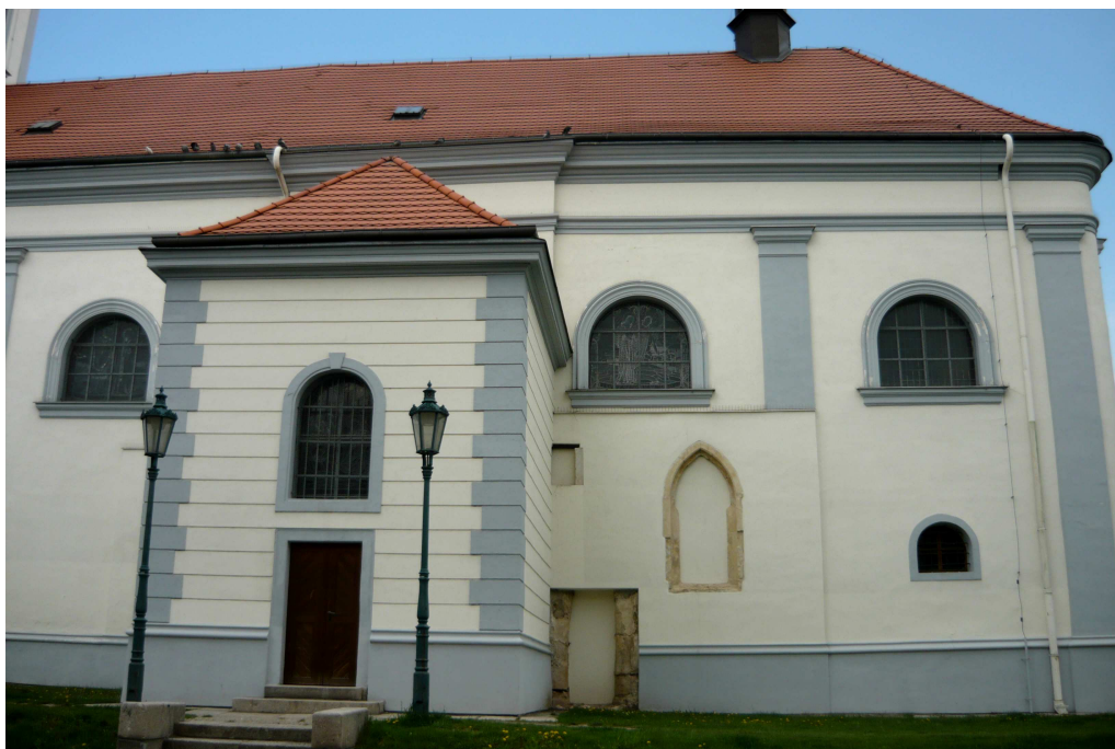
2. Fragmenty jižního zdiva a přízemí jižní věže, 3. čtvrtina 13. století a 2. polovina 14. století, pohled z jihu
