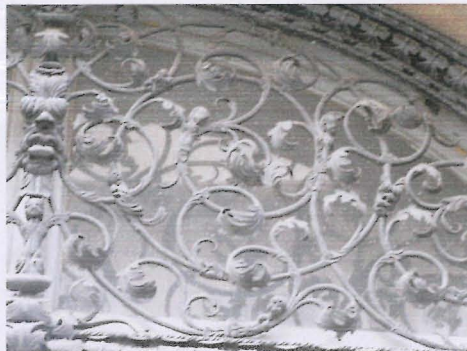
192 b – detail pravé části světlíku
