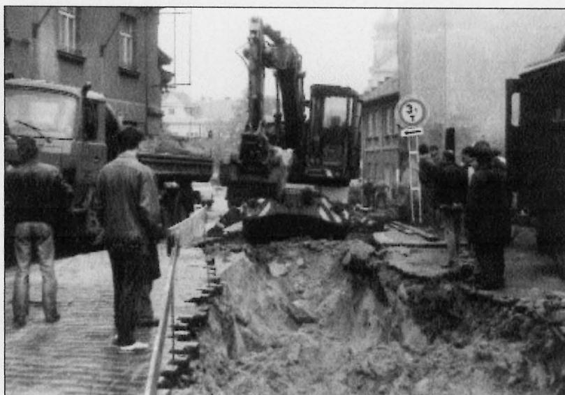
Obr. 6. Stará Boleslav 1989. Sonda P – prostor zúžení při bráně gotického opevnění. Bagrování výkopu pro hlavní řád plynu v místech hradištního příkopu. Foto od západu.
