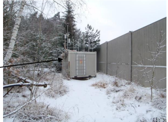
Obr. 6b. Odběrová stanice Dobré Štěstí
