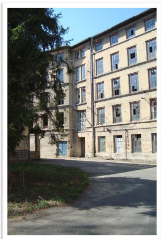
Rozbitá okna, zpuštělé fasády
