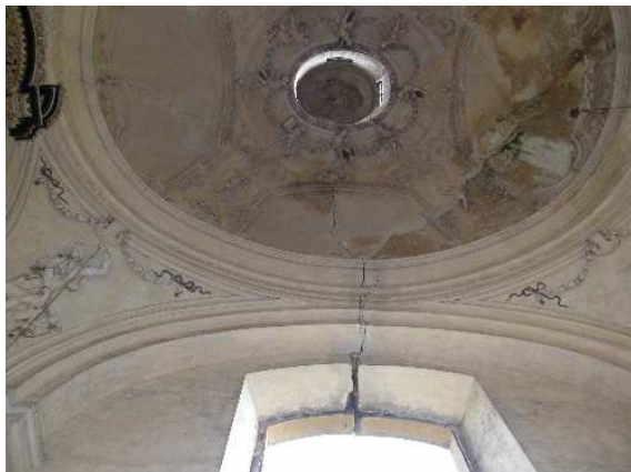
10. Liběšice, prasklina v jižní stěně kaple sv. Františka Xaverského
