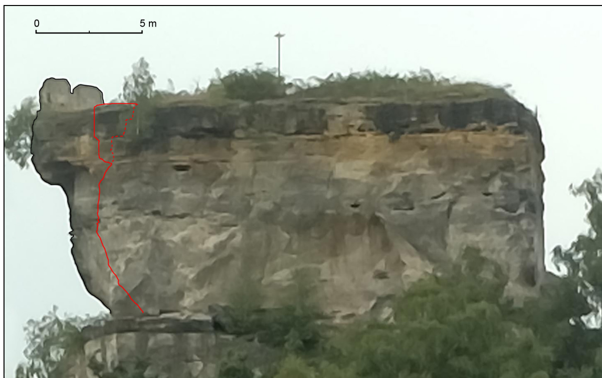
Obr. 27 – Silueta vrcholu západního masivu před skalním řícením dne 1. 10. 2009, pohled od jihu. Červená linie – stav po řícení 1. 10. 2009, červená přerušovaná linie – stav po sanaci 31. 10. 2009. Foto J. Adamovič, upraveno.
