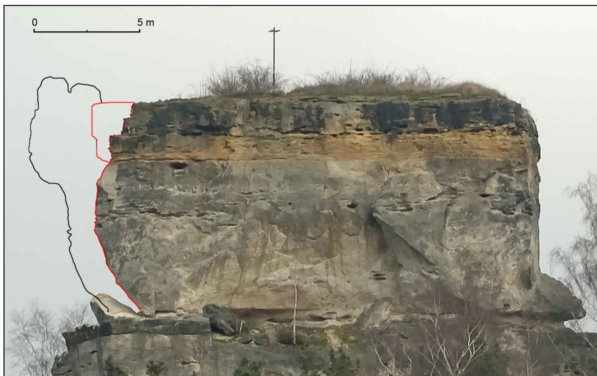
Obr. 28 – Silueta vrcholu západního masivu po skalním řícení a sanaci dne 31. 10. 2009, pohled od jihu. Černá linie – stav před 1. 10. 2009, červená linie – stav po řícení 1. 10. 2009.
