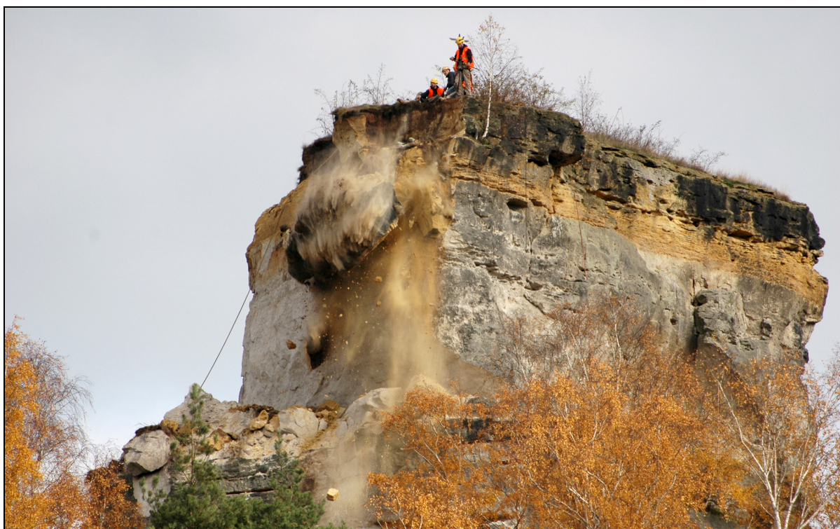
Foto 40 – Shoz nestabilního bloku 3. Pohled od jhozápadu.
