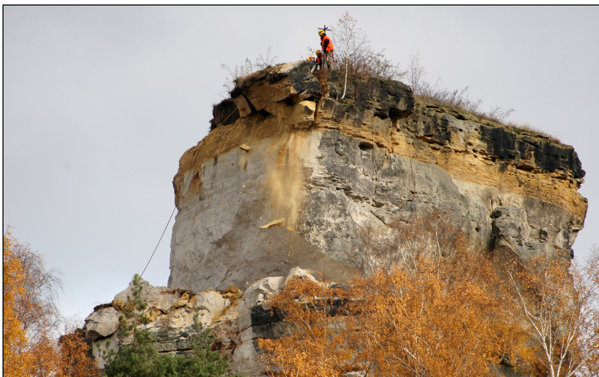
Foto 39 – Shoz nestabilního bloku 2. Pohled od jhozápadu.
