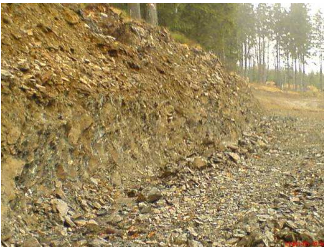
Příloha 11: Terénní úpravy na sjezdové dráze Labská ve Špindlerově Mlýně. Zásahy do půdního krytu jsou při výstavbě nových sjezdových tratí značné. Foto: Autor 11. 11. 2005, Špindlerův Mlýn.
