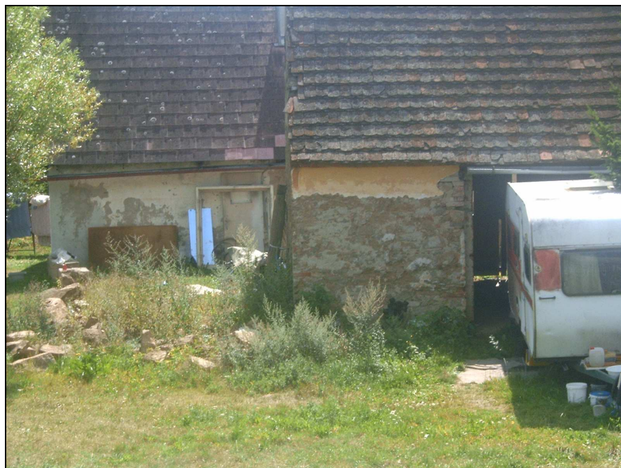
Obrázek č. 30: Nepřímý indikátor – stopy po povodni na budově v obci Dolní Ostrovec (Foto: Bažatová 2007)
