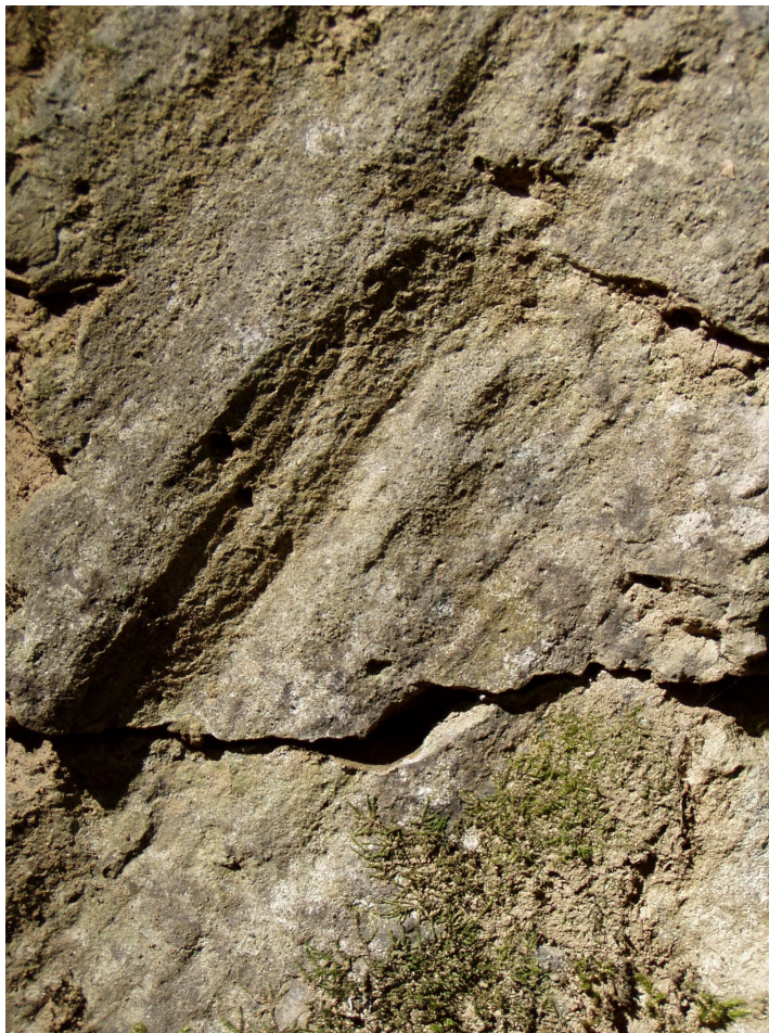
Obr. č. 28: Ryhovanie na šmykovej ploche 173/85 svahovej poruchy na lok. Lesy. Plocha bola odhalená pri ťažobnej činnosti.
