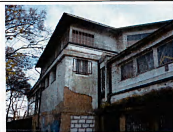
Obr. č. 10 Zchátralá část budovy.
