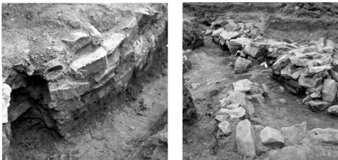
Obr. 1.38.: Starší a mladší líc vnější zdi v křídle brány (podle: Danielisová 2006g).
