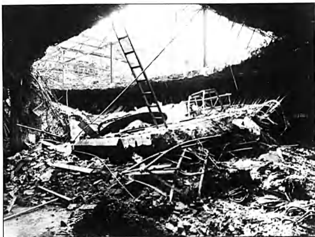
Snímek 11/II. Propadlá podlaha tovární haly (pohled zespoda)
