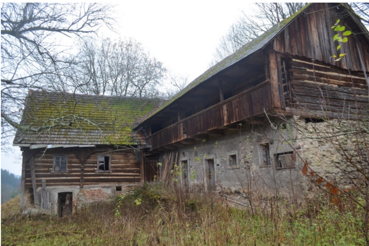
Obr. 45: Zanikající dům čp. 6 v Trávníčku.
