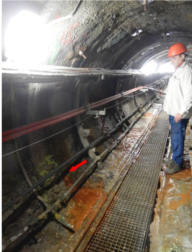
Obr. 9. Přítok na metrži 54,5 m v KT Holešovice po sanaci, foto V. Goliáš 28. 1. 2020
