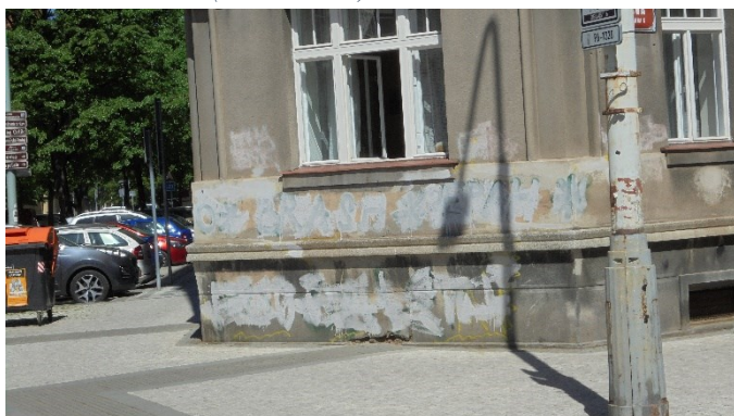
Obrázek 5.1.6: Nevzhledné odstranění a nátěr v ulici Sukova (7. 5. 2020)
