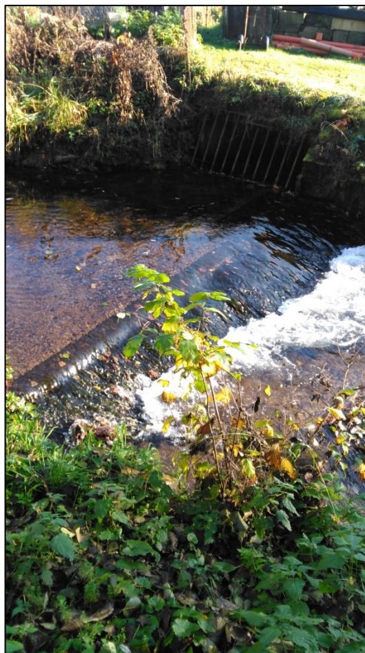
Obr. 33: Skluz v obci Česká Metuje, úsek MET001 (Foto: dílo autora)
