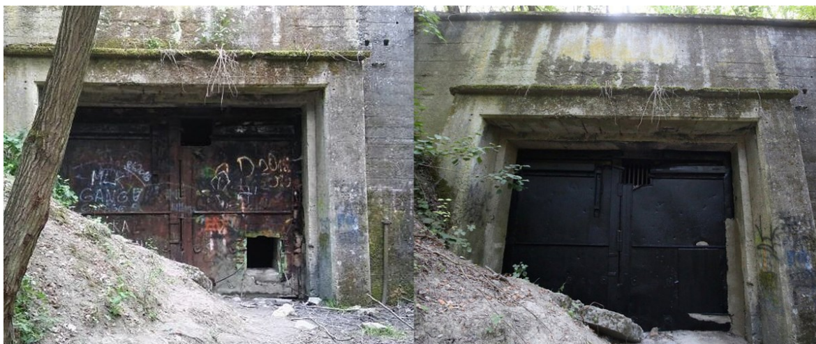
Příloha č. 23: Proměna vchodu do Richardu I. – vlevo starý vchod, vpravo nový.
