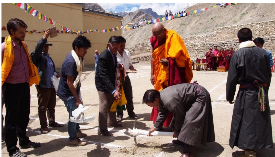
Obrázek 25 Vytyčení základního kamene pro nové školní laboratoře během prázdninového dobrovolnictví v roce 2017
