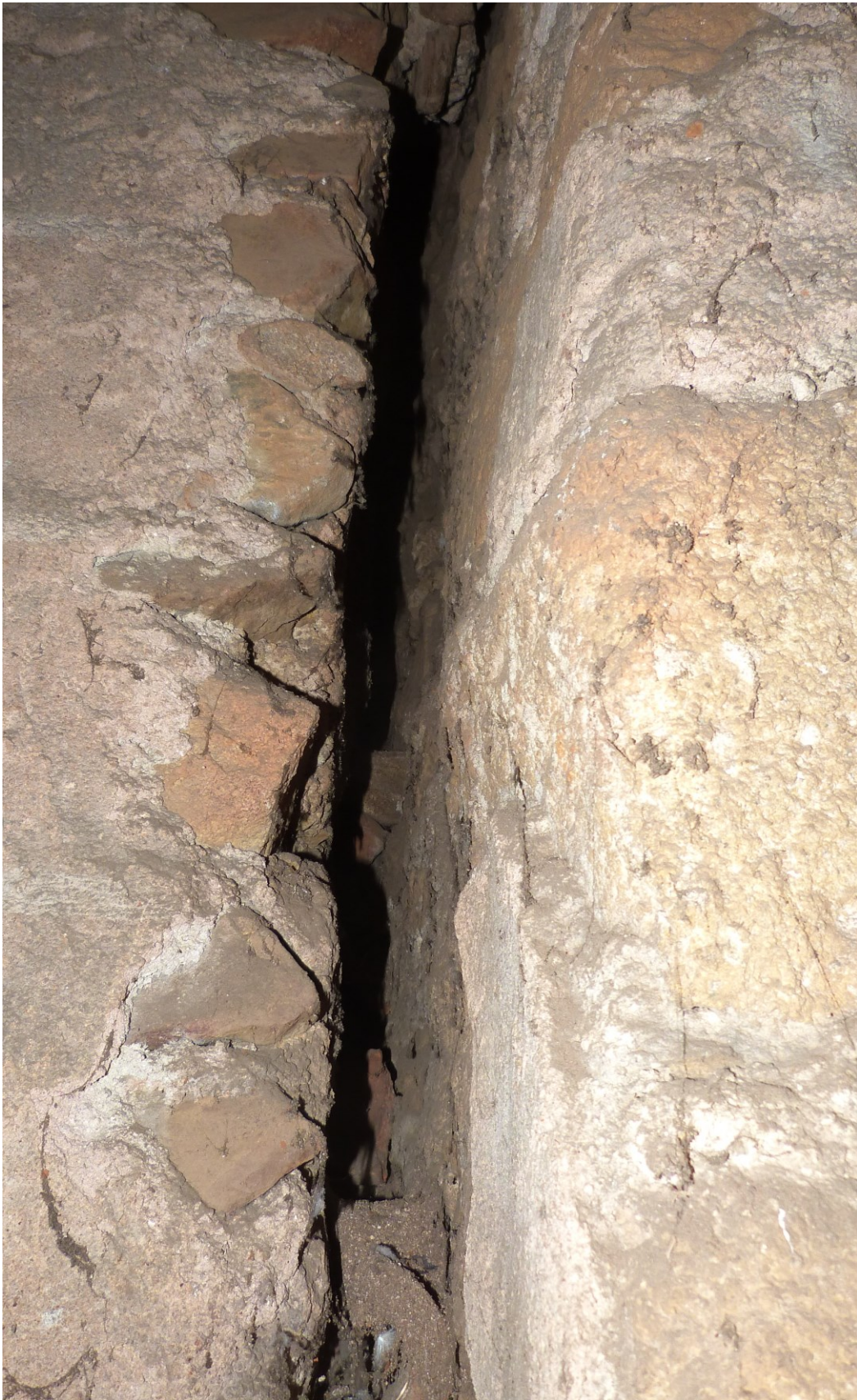
12. Pelhřimov, kostel sv. Bartoloměje, spára na styku presbytáře a hlavní lodi
