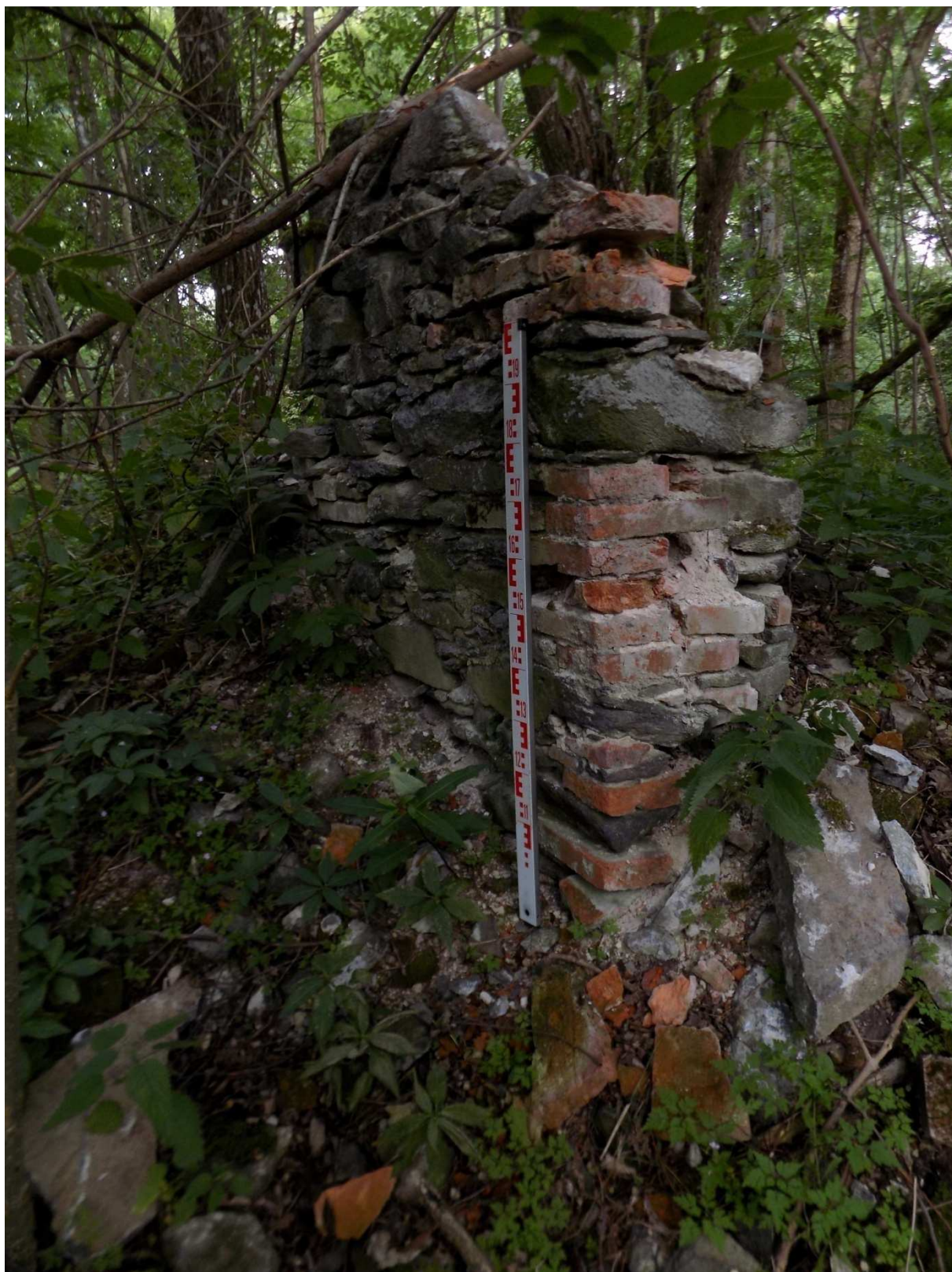
Obrázek 103: Volfštejn. Objekt č. 9 – pozůstatky zdi v jihozápadním nároží objektu. Foceno z východu.
