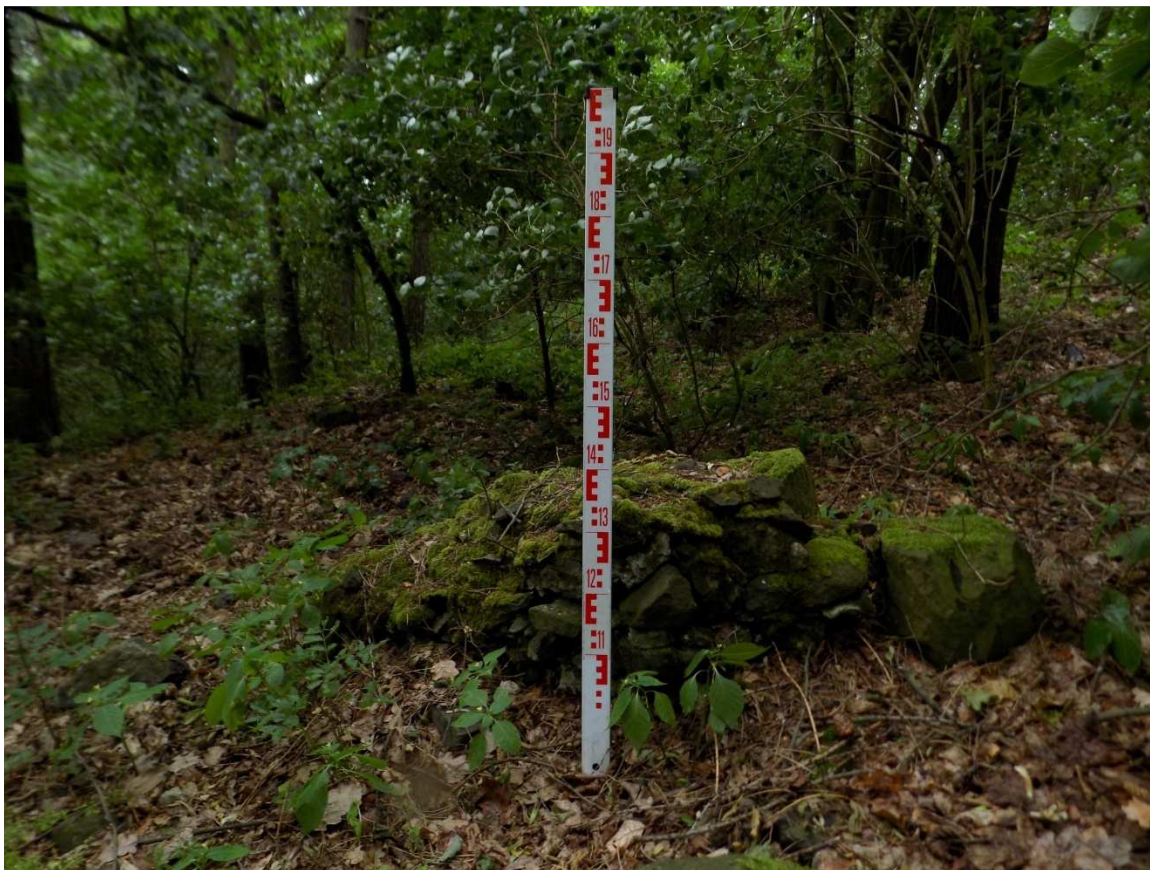
Obrázek 39: Košťálov. Objekt č. 1 – střední část komunikace s pozůstatky zdi. Foceno ze západu.
