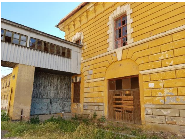
Obrázek 16: Velice špatný stav opuštěných budov v Žižkově ulici
