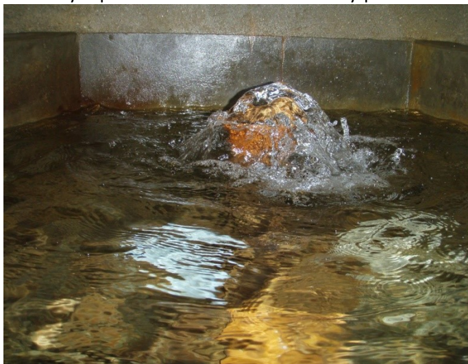
Obr. 17 Hlavní přítok do čerpací stanice pod Bezručovým pramenem o výkonu 240 l/min ze tří jímacích objektů nad Trojpramenem. Foto Viktor Goliáš 2015.
