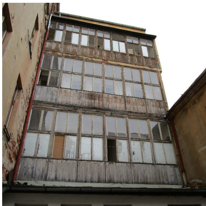
42. Žižkov , Vlčkova 409/11, pavlačový dům, kombinace zasklení a dřevěných obkladů ve špatném stavu
