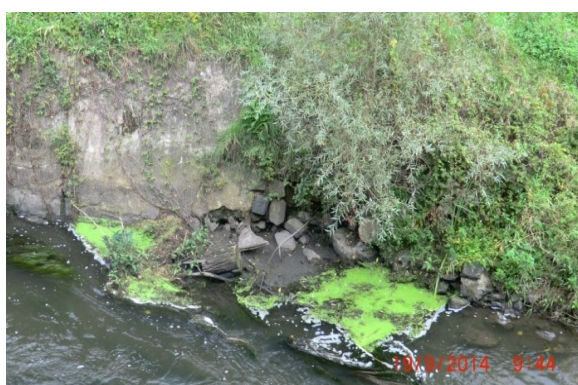
Obr. 24 Rozrušená betonová úprava břehu
