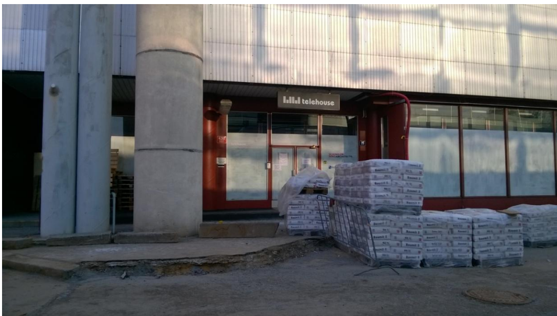
29. Automatická telefonní ústředna Dejvice (dále jen ATU Dejvice), pohled ze severní strany na hlavní vchod do budovy
