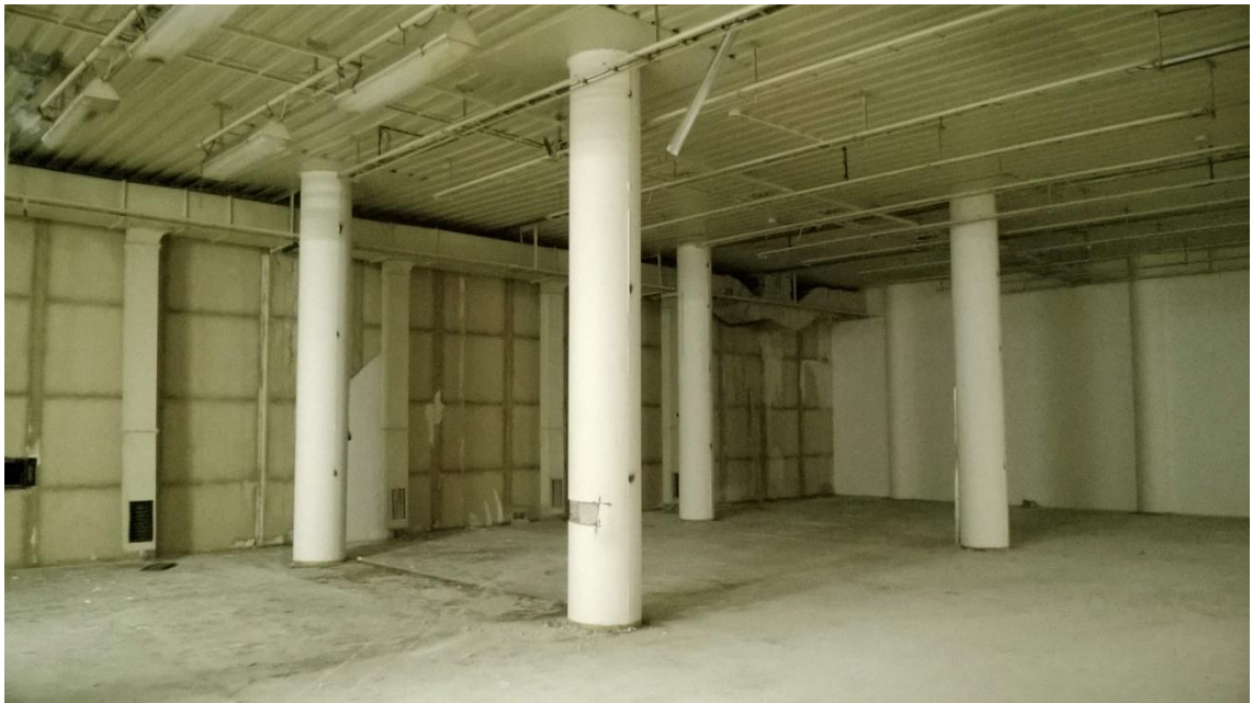
32. ATU Dejvice, pohled do jedné z mnoha místností pro technické zařízení
