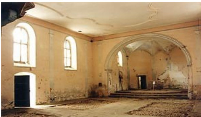
Interiér kostela před opravou.
