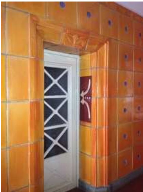
obr. č. 114 Glazovaný obklad stěn
